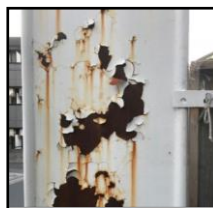
現実世界の塗膜剥離
