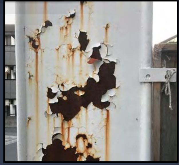
現実の塗膜剥離
