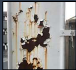
現実の塗膜剥離
